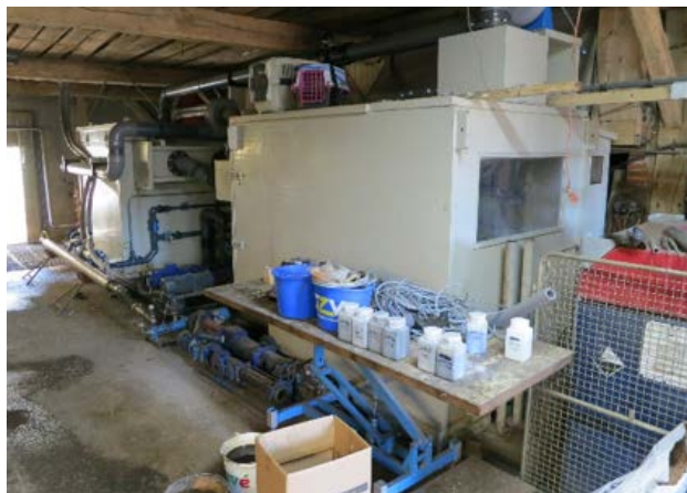
N-stripper (achter) en N-scrubber (voor) bij APF in Haarlo.
